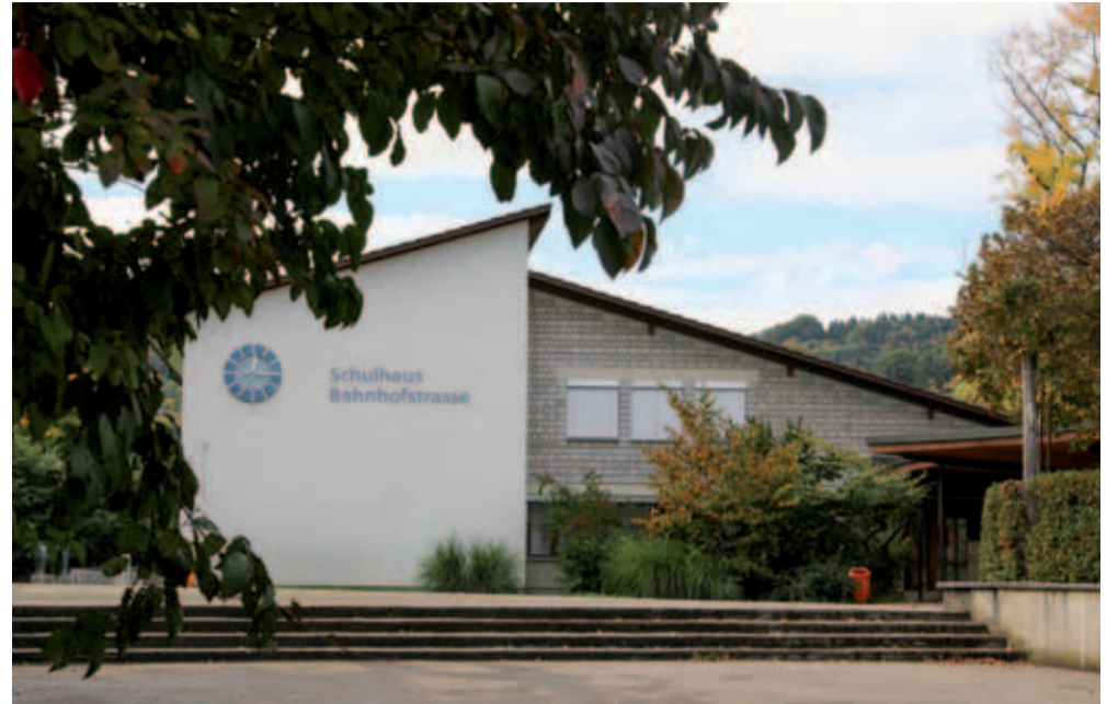
Sanierungsbedarf zeichnet sich ab – wie hier beim Schulhaus Bahnhofstrasse.
